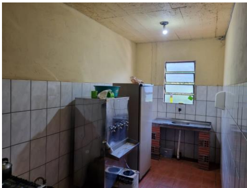
Imagem da parte interna da cozinha.
