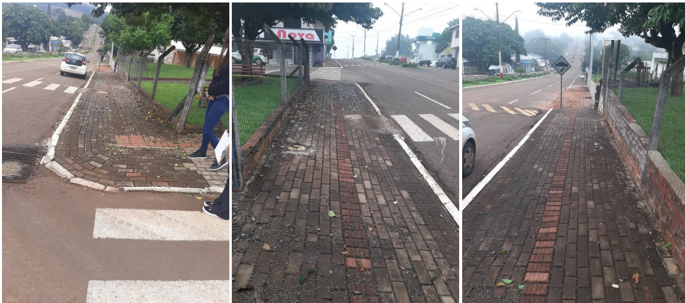
Imagens da calçada existente – as peças deverão ser totalmente removidas.
