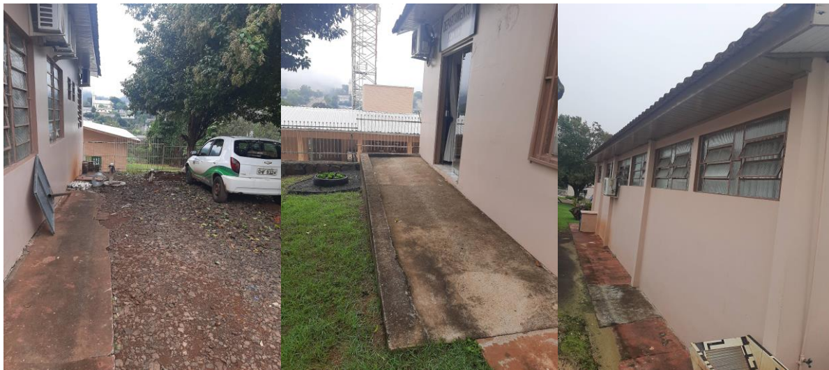
Imagens das calçadas do entorno a recuperar
